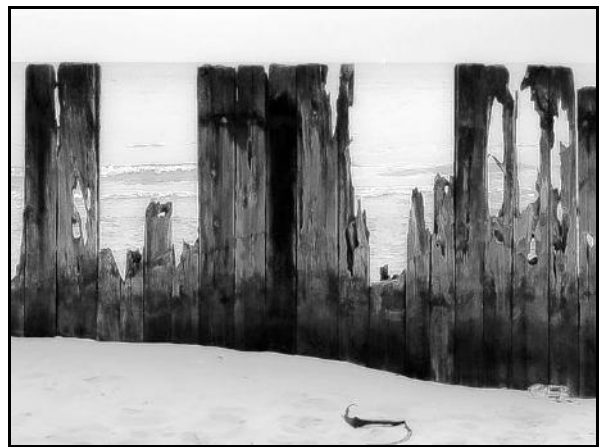
Das Bollwerk beginnt zu bröckeln (Ostsee bei Kolobrzeg, 2008)
